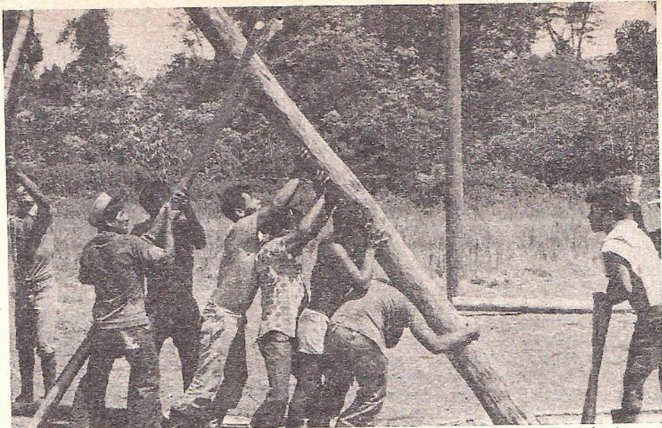
Los hombres colocan uno de los postes laterales que sostendrán la estructura de la maloca.
